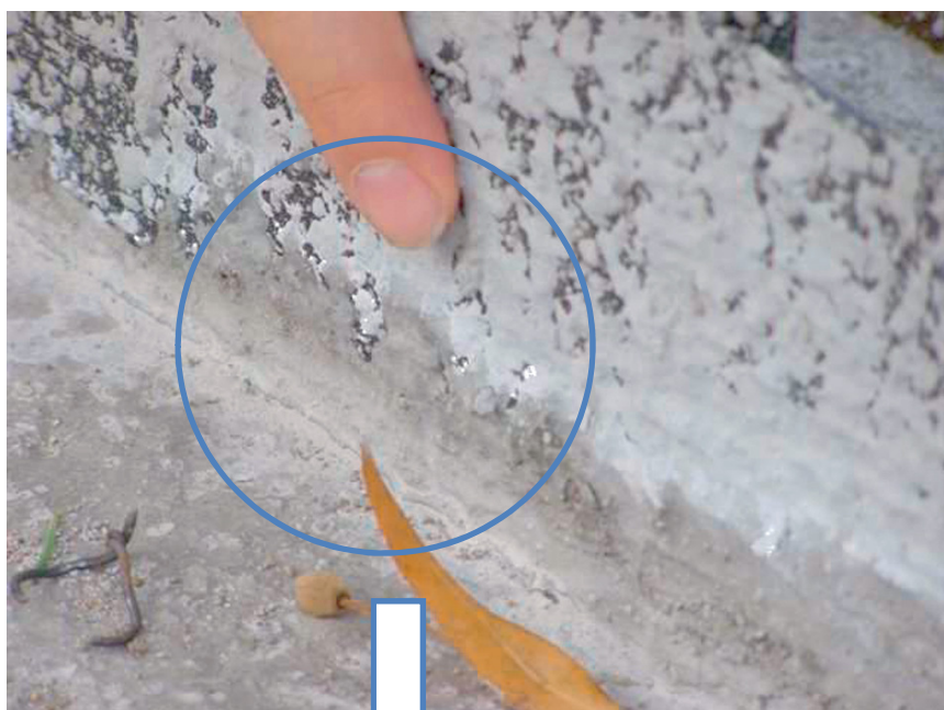
Duxpa-Fugenblech - widoczna krystalizacja
